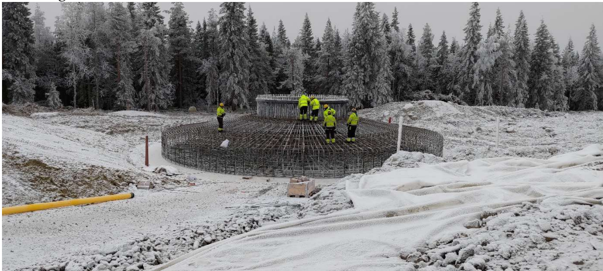
Figur 7. Gravitationsfundament innan gjutning i en av Bolagets vindparker. Foto: Fred. Olsen Renewables AB.
